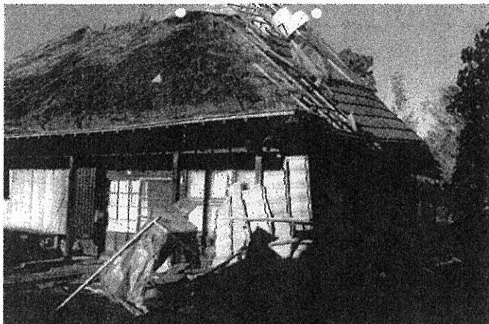
写真3: [redacted] 公費解体 屋根の損壊
