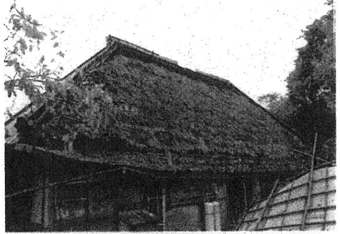
写真2: [redacted] 屋根の損壊 公費解体
