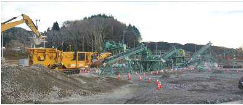
岩手県山田町地区のコンクリートがら破砕ライン (H24.11 追加。12.10 本格稼働開始)
