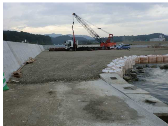
南三陸町の志津川漁港南防波堤復旧工事 （平成 25 年 7 月開始）
