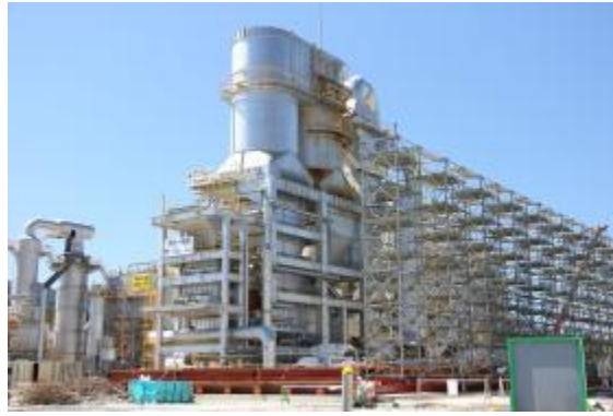
(a) 宮城県気仙沼処理区小泉地区の仮設焼却炉の解体を開始
