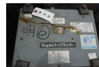
トランス類(PCB含有無し)
