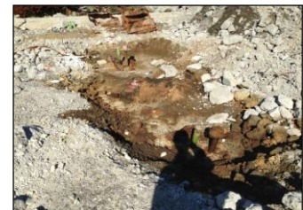
油混じりの土砂保管状況
