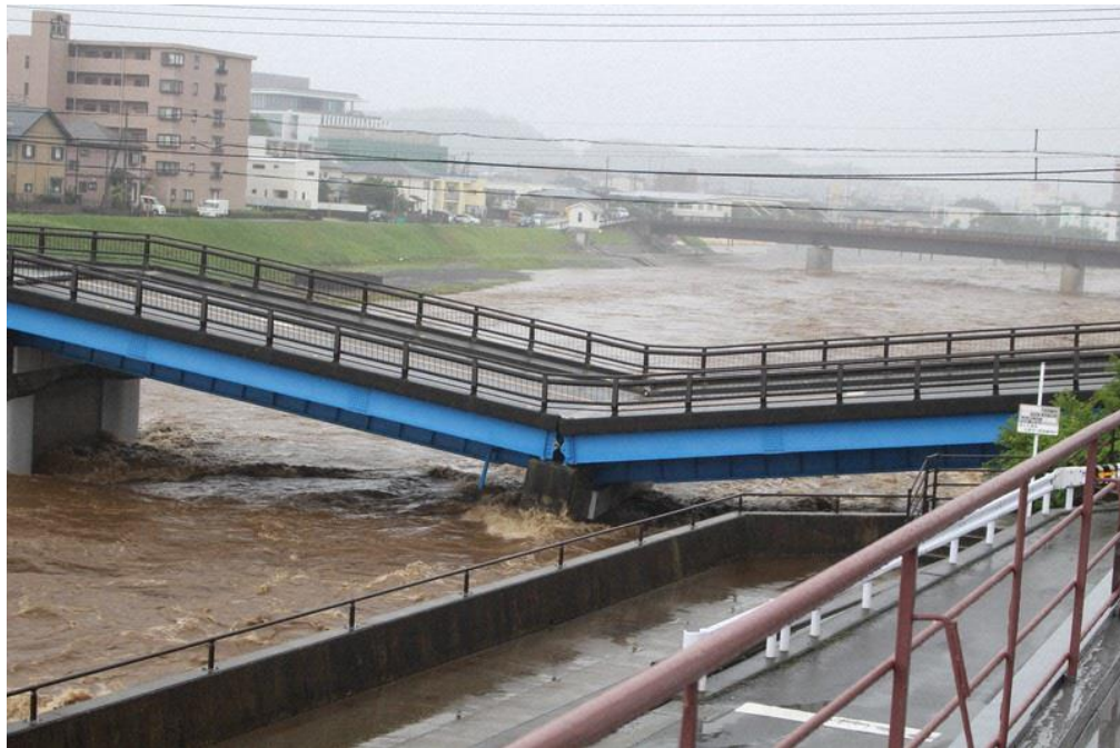
黄瀬川大橋の橋脚の損壊
