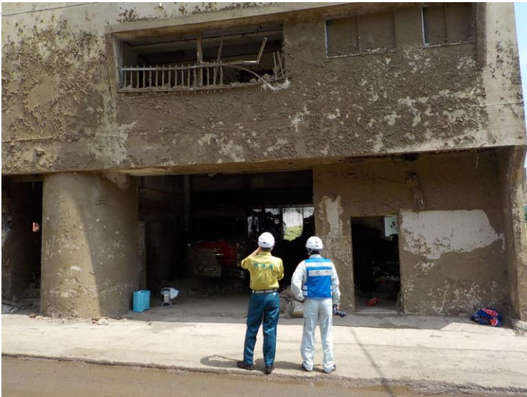
土石流により被災した現地確認
