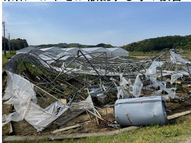
農業用ハウスの倒壊被害
